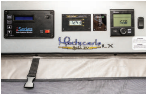
Centre de contrôle : voltmètre et ampèremètre numériques pour la gestion de l'énergie.
